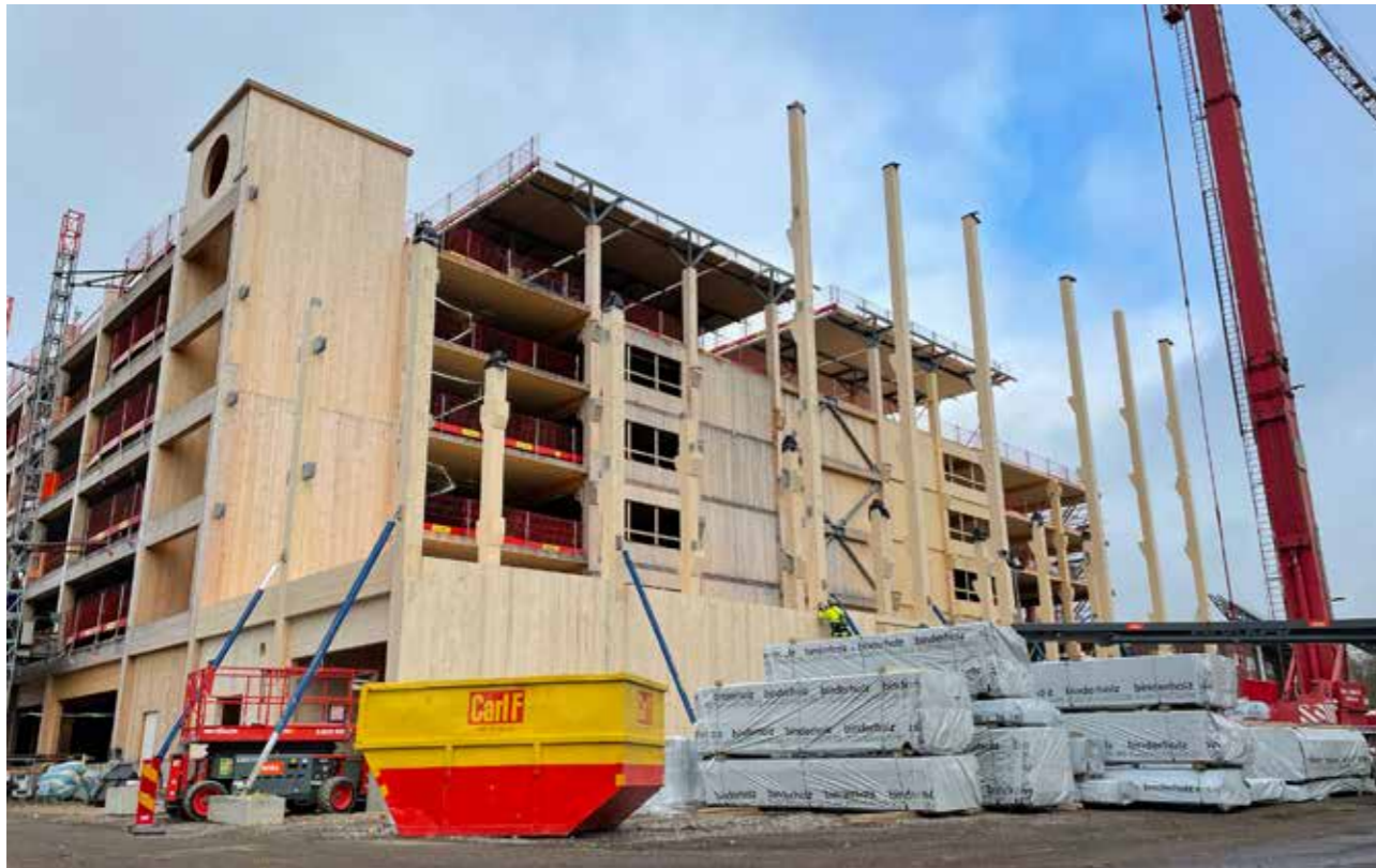
Parkeringshuset i Sege Park ska bli Parkering Malmös spjutspets inom klimat och innovation. P-huset ska byggas i trä, innehålla ett stort antal laddplatser för elfordon, solceller, dagvattenåtervinning, smarta lösningar för optimering av energiflöden, växtklädda fasader mm.
