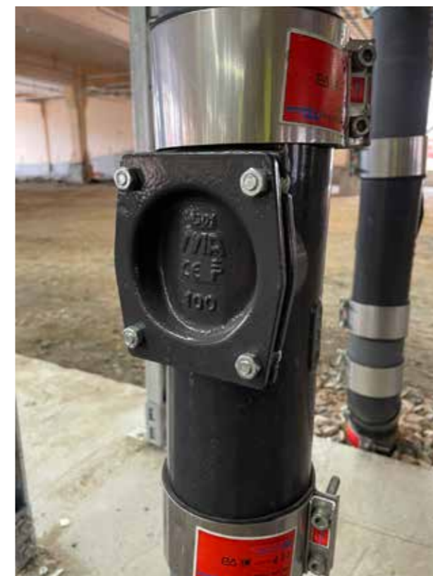
På bottenplan har man installerat MA-SYSTEM® PLUS Rensrör så att man enkelt kommer åt om man behöver rensa.
