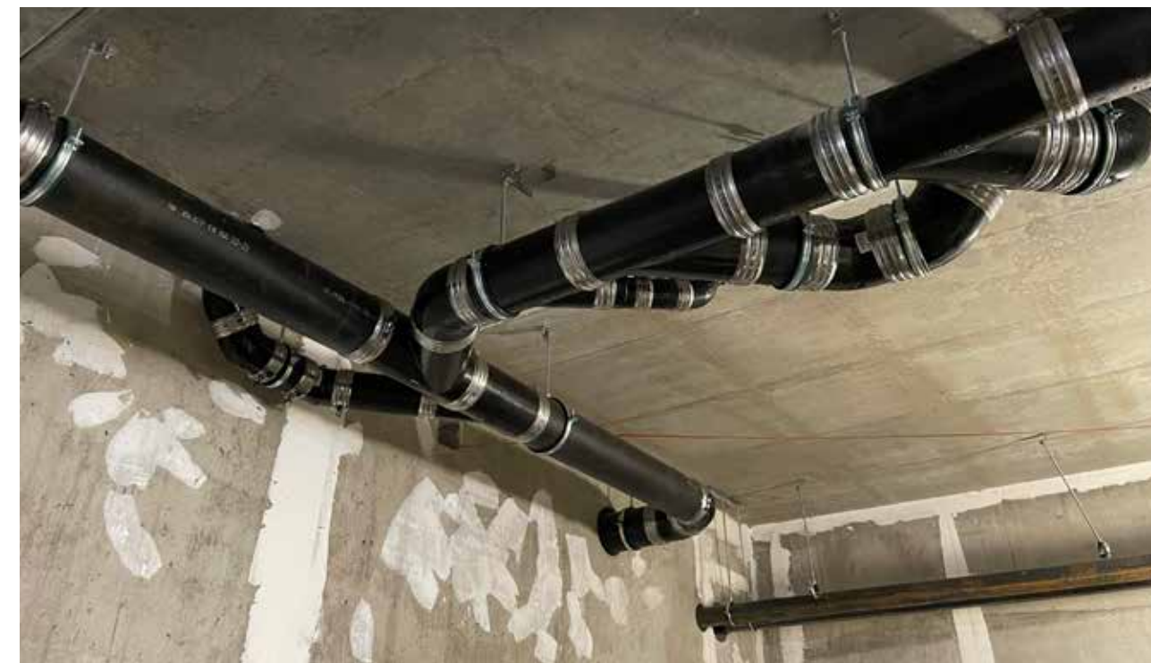
MA-SYSTEM® är uppmonterat med gängstång som sitter fast med klamsvep.
