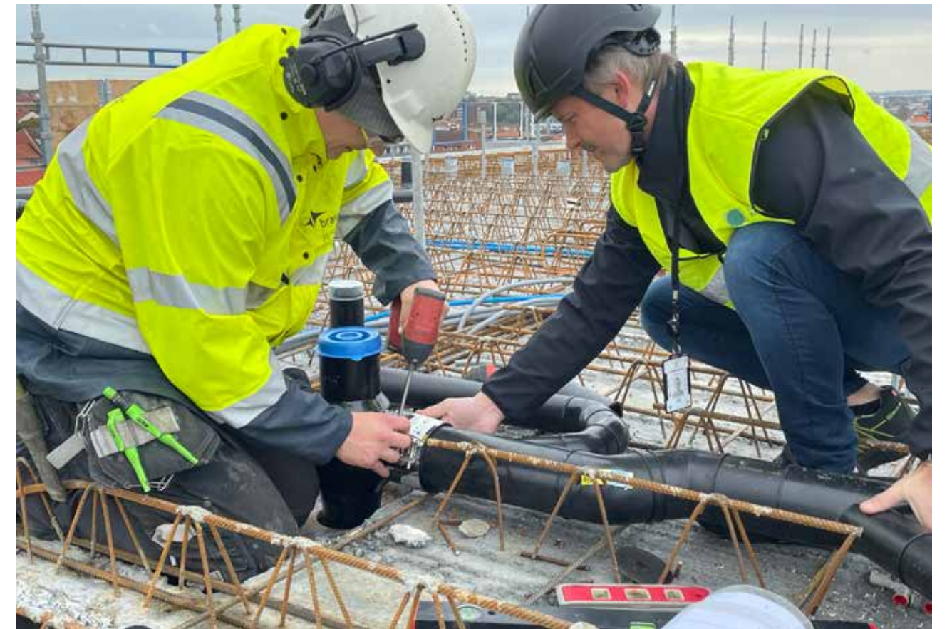
Staffan Ecklein, vår MA-Representant var på plats när spiralgrenrören på nionde våningen installerades.
