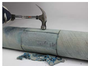
Genom att knacka med en penhammare eller motsvarande kan betongen nu avlägsnas.
